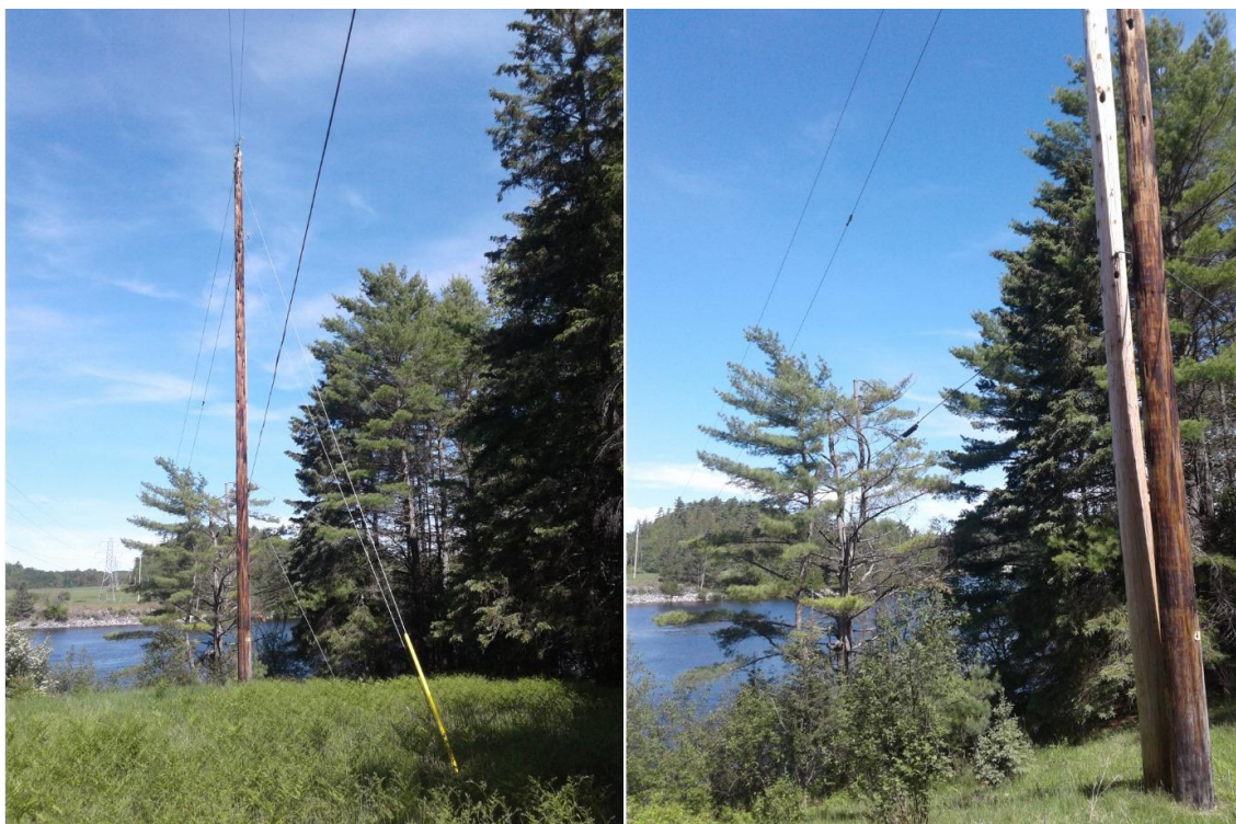
Figure 5-2 : poteaux dans le secteur de la traversée de rivière, non loin du barrage de Paugan, en Outaouais(Hydro-Québec, 2020a)
