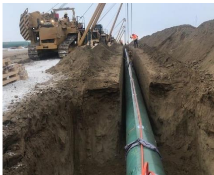
Figure 5.11 : Aperçu d'un pipeline onshore enterré
