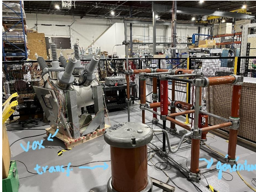
Figure 5.8 : Banc de test expérimental pour les tests aux chocs de foudre avec les équipements de Energie Conseil Olivier
