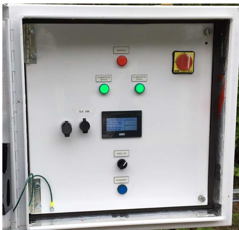
Figure 4.2 Voyants d'alimentation et d'anomalie dans le panneau d'alimentation
